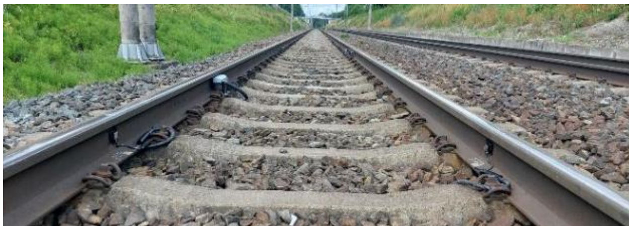
Obr. 6 Pohled na umístění snímačů v koleji (na stojinách obou kolejnicových pásů snímače zrychlení, vlevo na kolejnici detektor náprav – šedý kryt).
