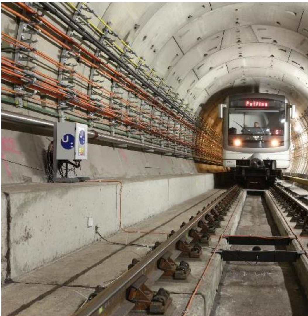
Obr. 4 Zařízení DiPo/DiMet v provozu metra (1x DAQ, SW SDAQ, sensor v2).
