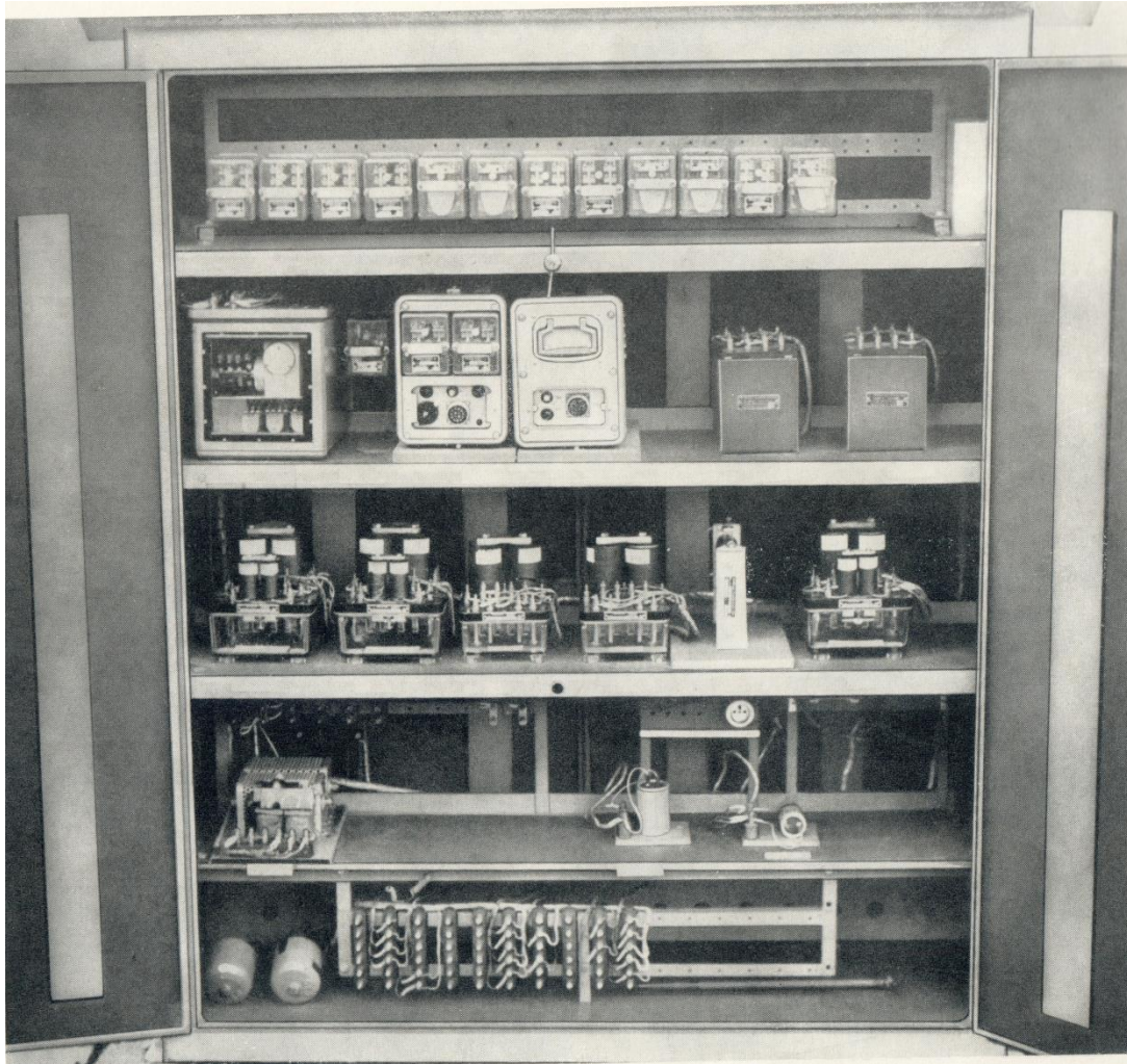
Skříň automatického bloku
