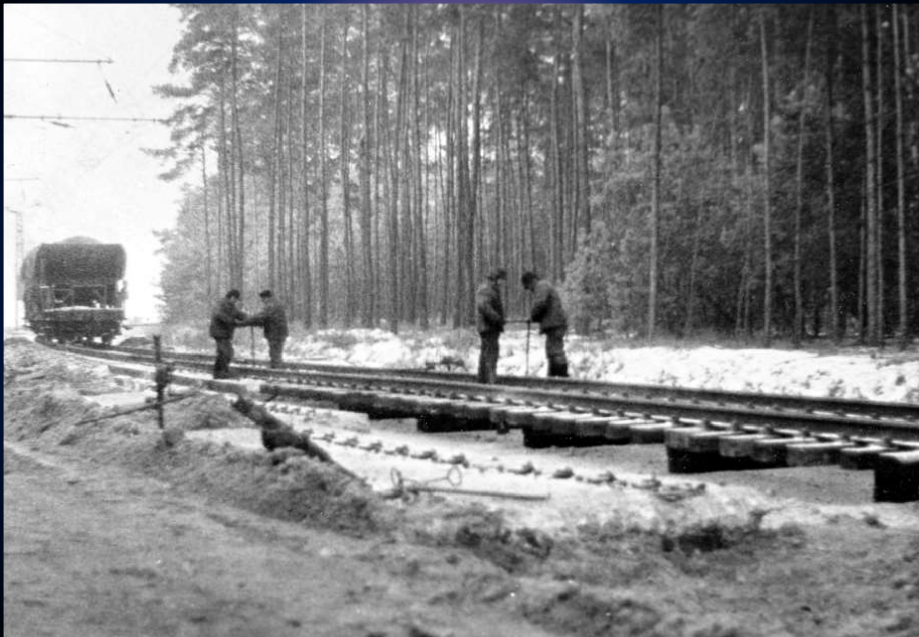
Na MZO byly od počátku použity různé zkušební úseky traťového svršku (zde BR desky). foto: 1976 Snímek z poč. roku 1976 zachycuje náhradu jednoho z nich klasickým svrškem s pražci. sbírka R. Kolmačka
