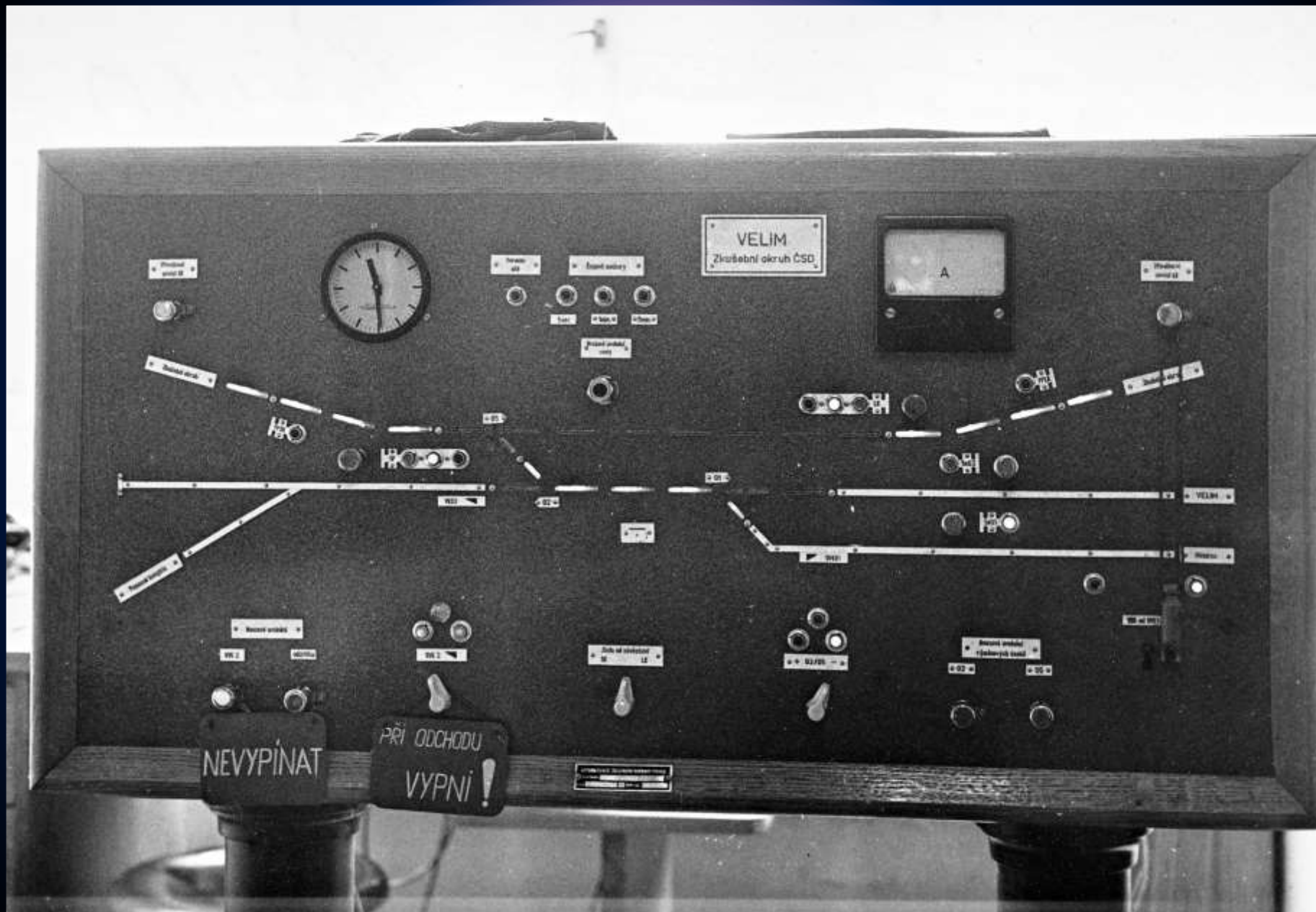
Podoba ovládacího panelu zabezpečovacího zařízení v dopravní kanceláři ŽZO už po dostavbě kolejiště VÚKV.
