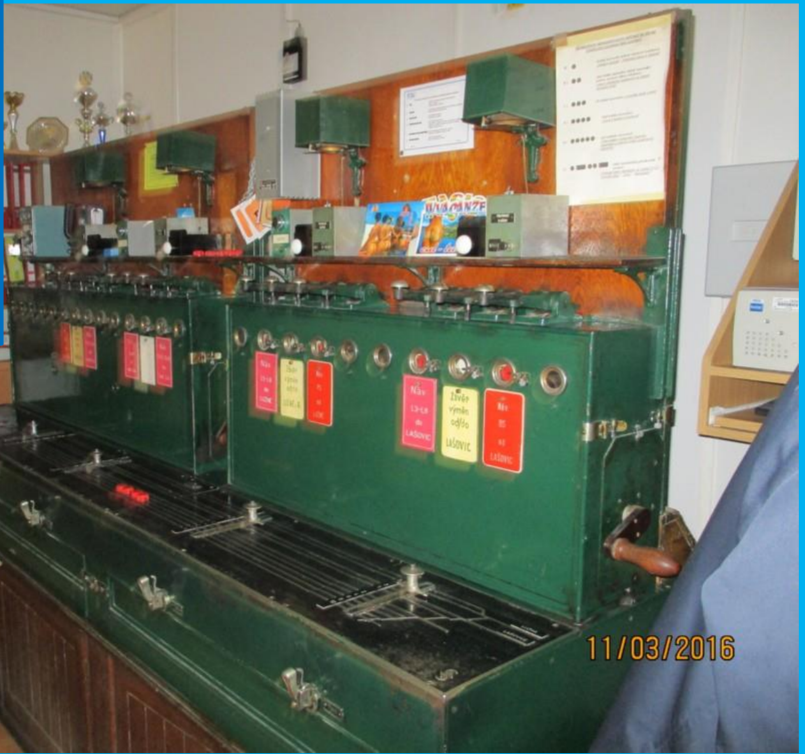
Rakovník – vpravo řídicí přístroj Rank v dopravní kanceláři. Na hradlové skřini v pravé polovině přístroje výpravčí povoluje vjezdy a odjezdy vlaků do směrů Lužná u Rakovníka a Beroun. EMZZ bylo ve stanici Rakovník instalováno až v letech 1930/31. Na obr. vlevo nahoře je ovládací panel RZZ pro zhlaví, z něhož odbočují další tři trati do směrů Louny, Bečov n. Teplou a Kralovice ...
